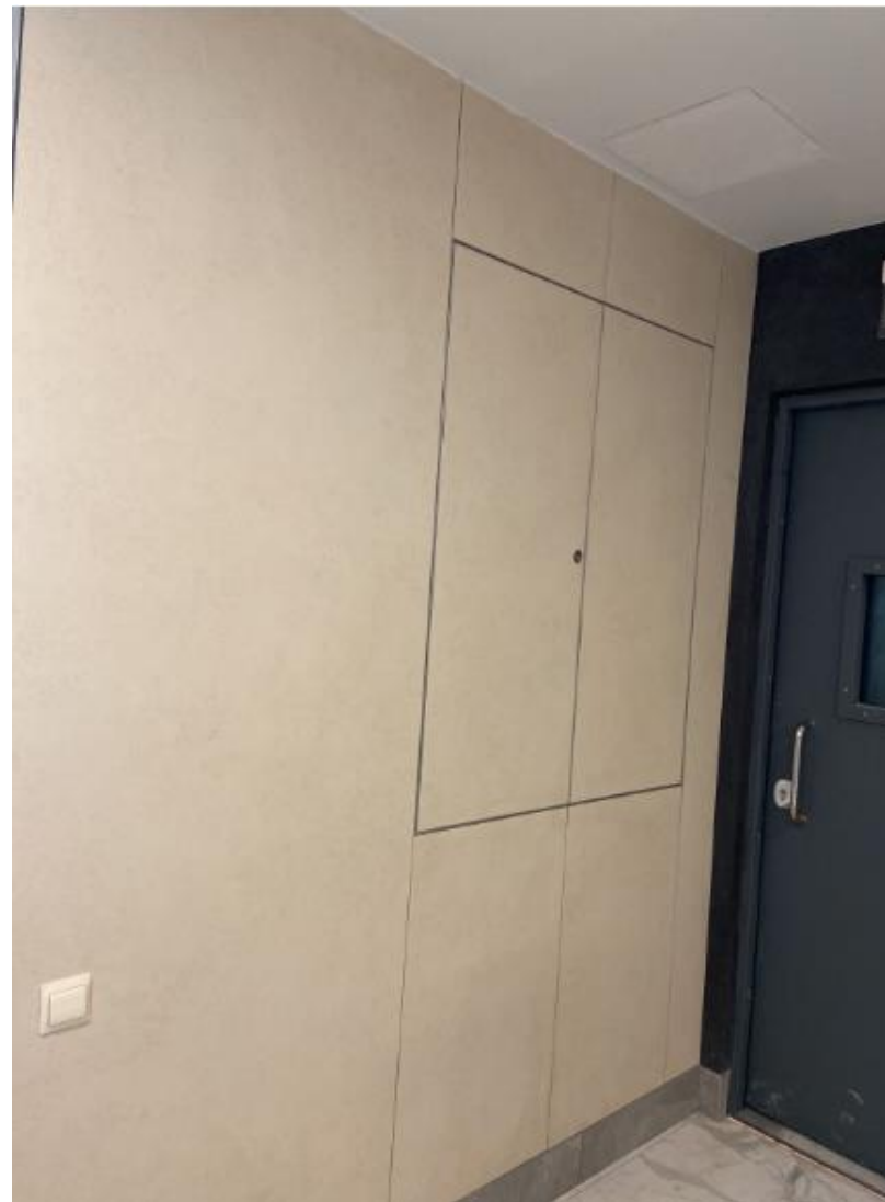
10. Инженерные ниши скрыты
