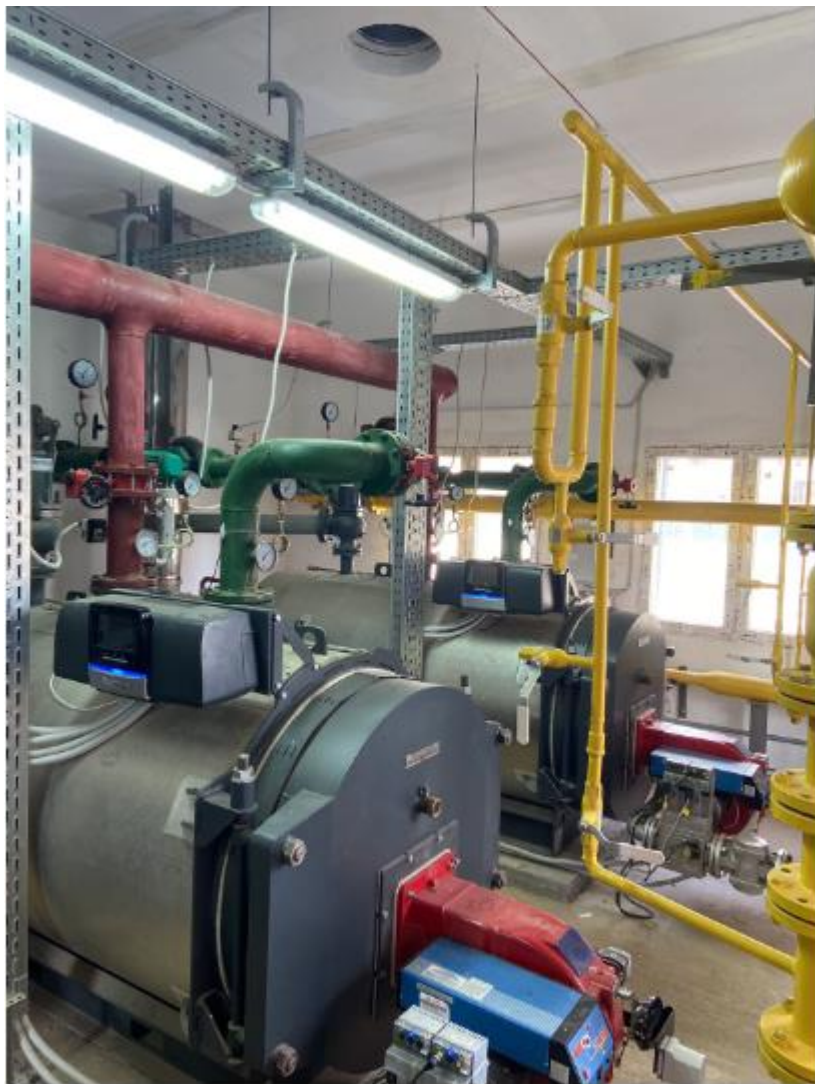
5. Придомовая или крышная котельная
