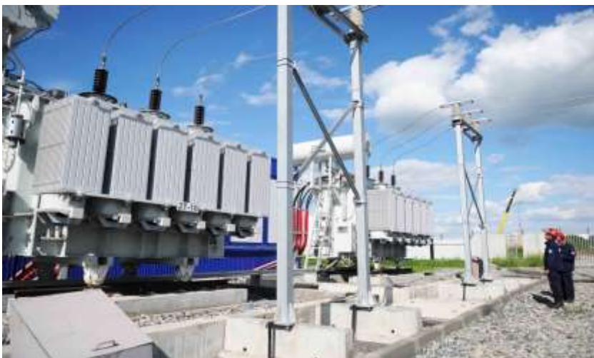
Новосибирские Региональные Электросети Низковольтное и щитовое оборудование
